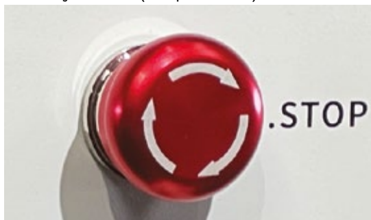
Фото 11.1.1. Кнопка аварийной остановки.
